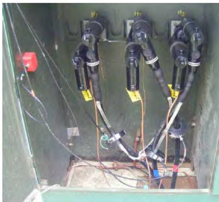
Рисунок 9: Закрепление датчика внутри корпуса распределительного устройства.
