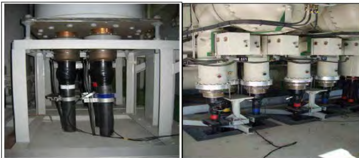
Датчик HFCT вокруг шины заземления высоковольтного кабеля на GIS 132 кВ.
