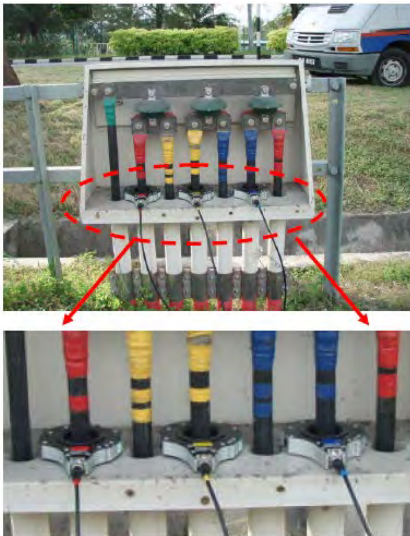
Рисунок 11: Фотография подсоединения датчика HFCT к точке перемычки на кабеле 132 кВ.
