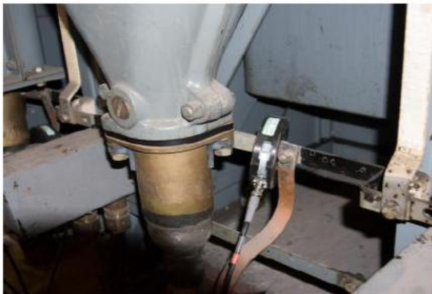
Рисунок 2: Установка датчика HFCT (высокочастотный трансформатор тока).
